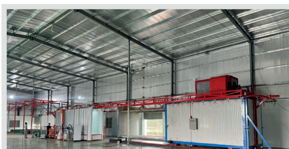
Dây chuyền sơn tĩnh điện Powder coating line
